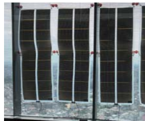
高層ビル窓に設置して発電
